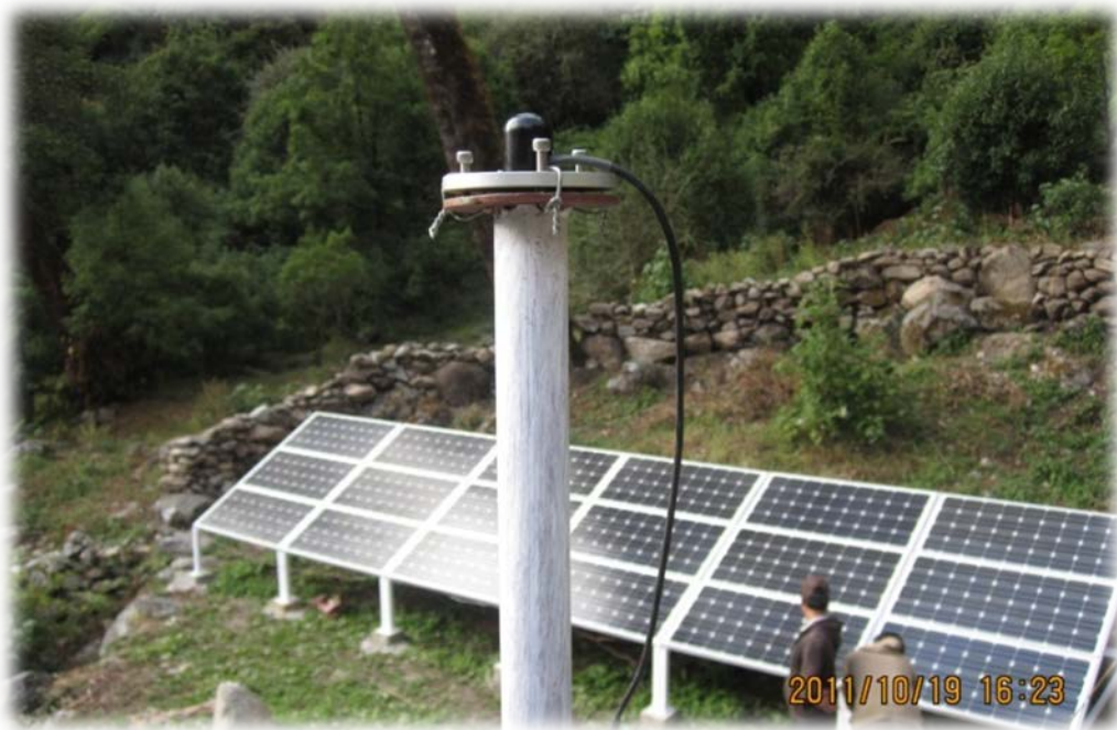
라마호텔에 설치된 태양광 패널과 측정장치
